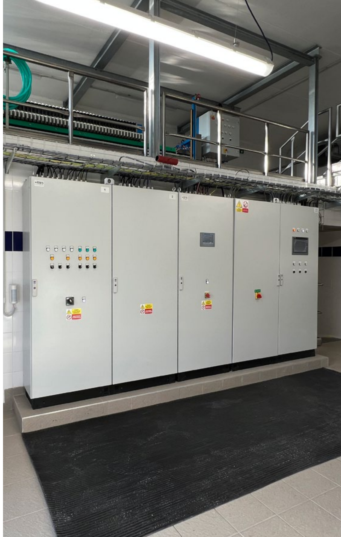
Společný rozváděč technologického celku odvodnění kalu a stanice pro přípravu flokulantu.
